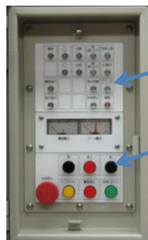
操作面(操作小扉内)
