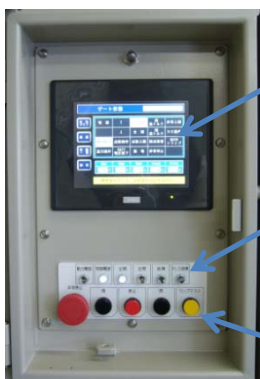
操作面(操作小扉内)
